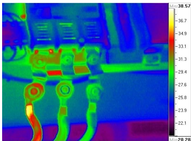
Рисунок 21. Пример термограммы контактных соединений с температурной шкалой
